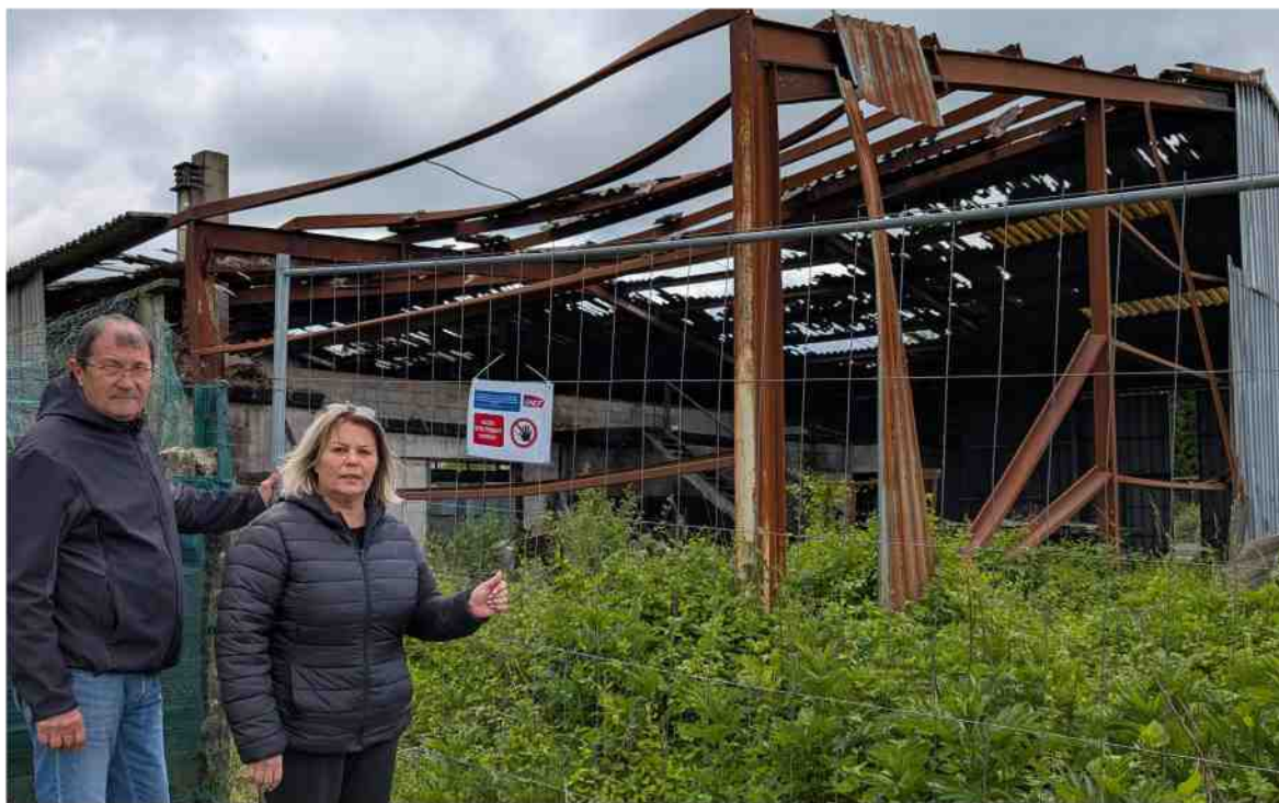
La maire Sandrine Précigout et son adjoint chargé des travaux, Jean-Michel Artaud, devant le bâtiment qui se dégrade. CL
